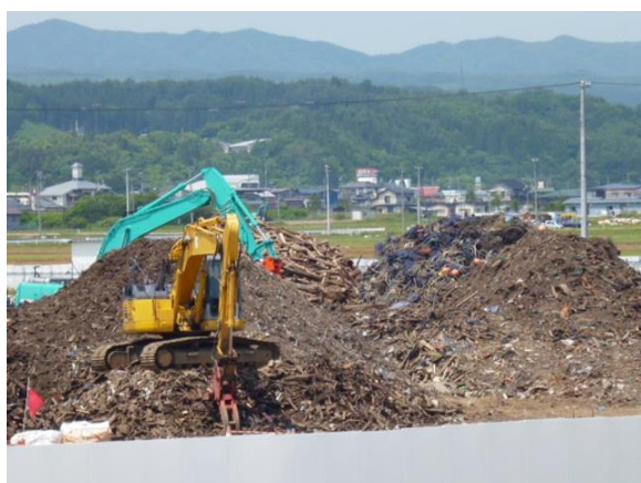
東日本大震災 (平成 23 年 3 月)
