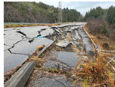
石川県七尾市 道路被害 (1月9日)
