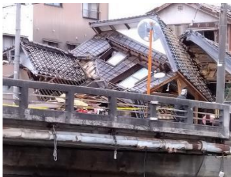
石川県穴水町 民家の被害 (1月5日)
