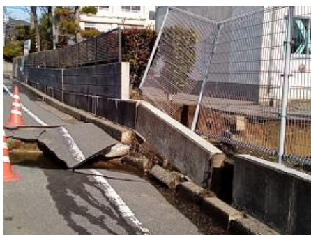
新潟県新潟市 路面の隆起 (1月2日)
