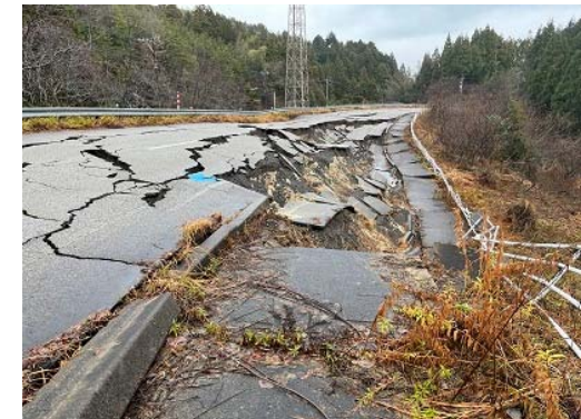
石川県七尾市 道路被害 (1月9日)
