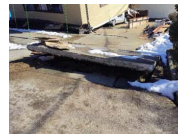
地震により浮き上がった浄化槽 (画像は珠洲市内の例)
