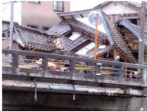
石川県穴水町 民家の被害 (1月5日)
