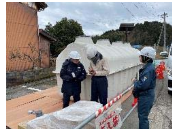
能登町での浄化槽の状況確認
