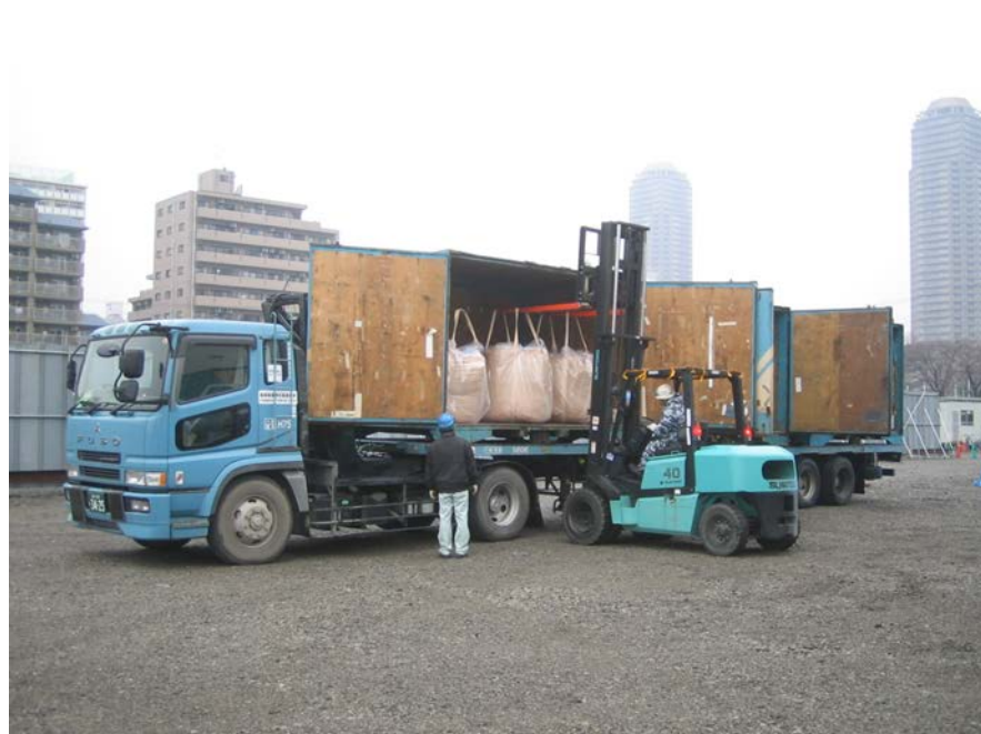
建設現場(東京都内)でフレコン詰めされた汚染土壌の積み込み
