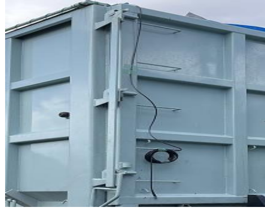
コンテナに設置した吸引ポンプユニット (拡大)
