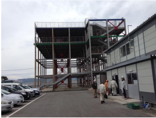
写真 4.4.1.5 津波被害を想定して仮設処理施設に緊急避難タワーを設置した例
