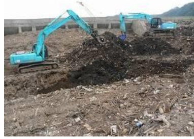
(2) 重機による災害廃棄物の山の掘削 岩手県宮古市田老一次仮置場
