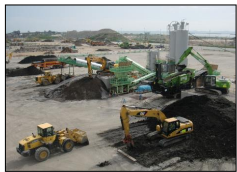
(右)津波堆積物処理施設 全景
