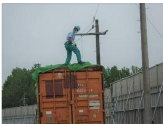
写真 4.4.1.4 搬出車両へのシート掛けの様子 (安全帯を使用するための柱を設置している)
