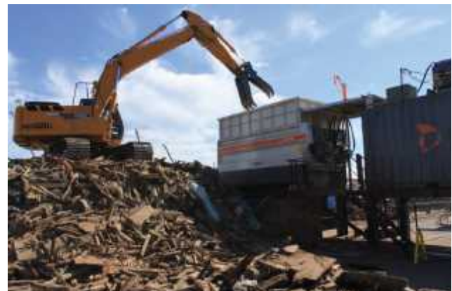
出典：石巻ブロック災害廃棄物処理業務現場だより
