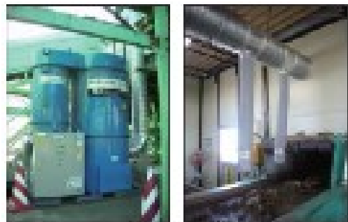
集じん機と集じんダクト
