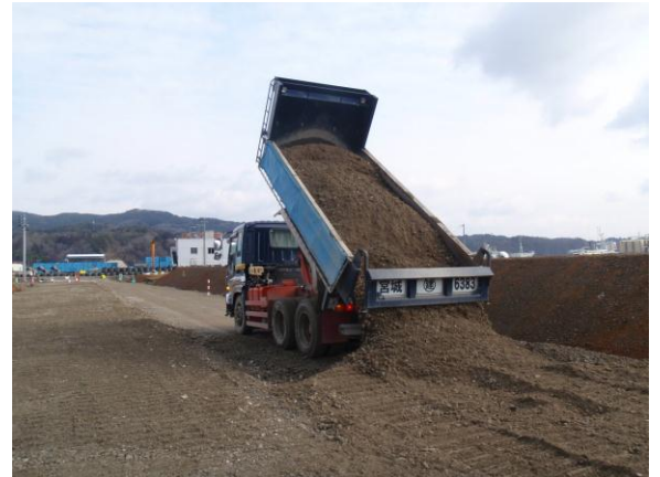
気仙沼市の気仙沼漁港南気仙沼地区 水産加工施設等集積地基盤整備工事 (H25 年 12 月開始)
