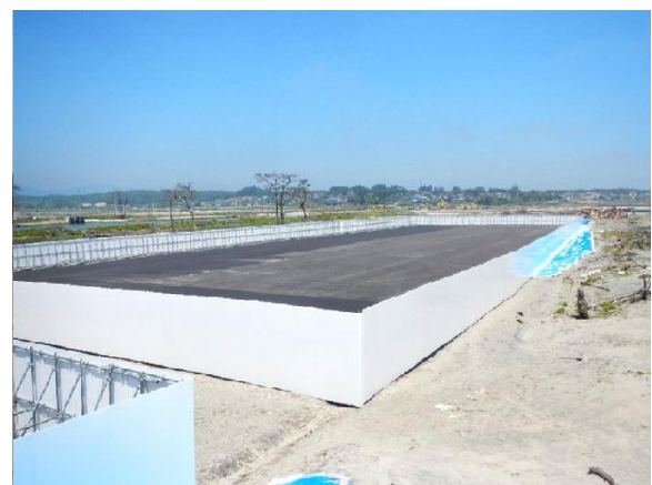
設置後（H25年6月4日撮影）
