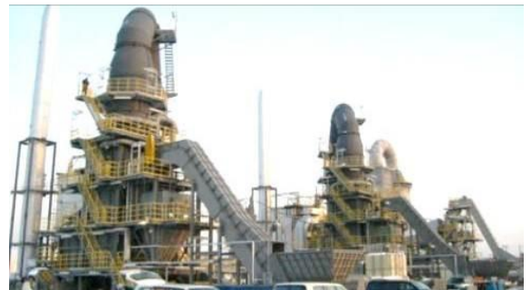
福島県相馬市仮設焼却炉（3基） （H25年2月20日～本格稼働開始）
