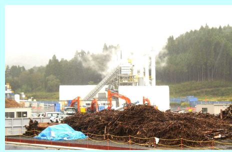
気仙沼ブロック南三陸処理区の仮設炉 （3基）（H24.9.15試運転開始）
