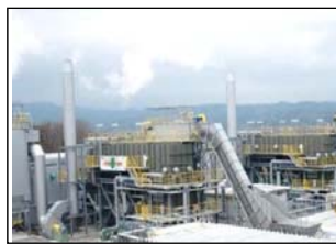
岩手県宮古市仮設焼却炉 (本格稼働開始:H24.3)
