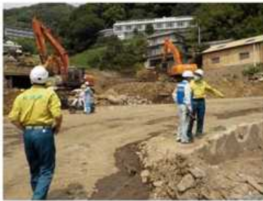
土石流により被災した現地確認 館山市撮影
