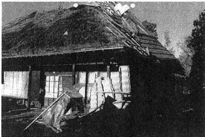
写真3: [redacted] 公費解体 屋根の損壊
